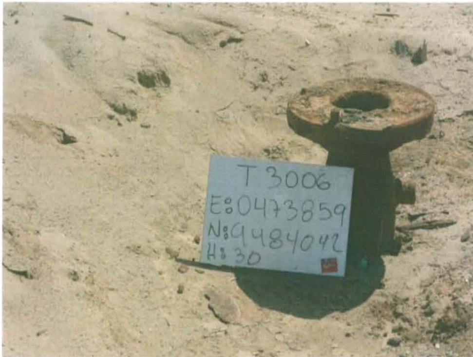
Fotografía N° 1. Pozo inactivo mal abandonado de la Ficha OEFA F00467, presenta casing corroído con brida y se encuentra abierto al ambiente.
