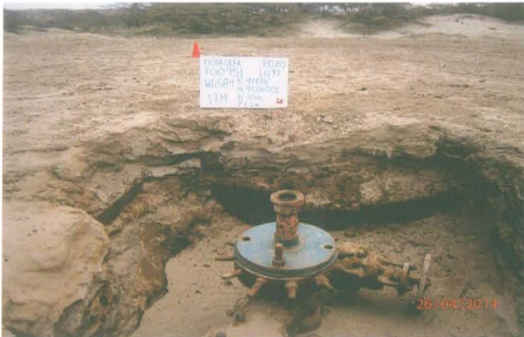
Fotografía N° 1. Vista de la ubicación georeferenciada donde se observa el pozo con el casing, la brida abierto y válvulas en estado de deterioro por corrosión.
