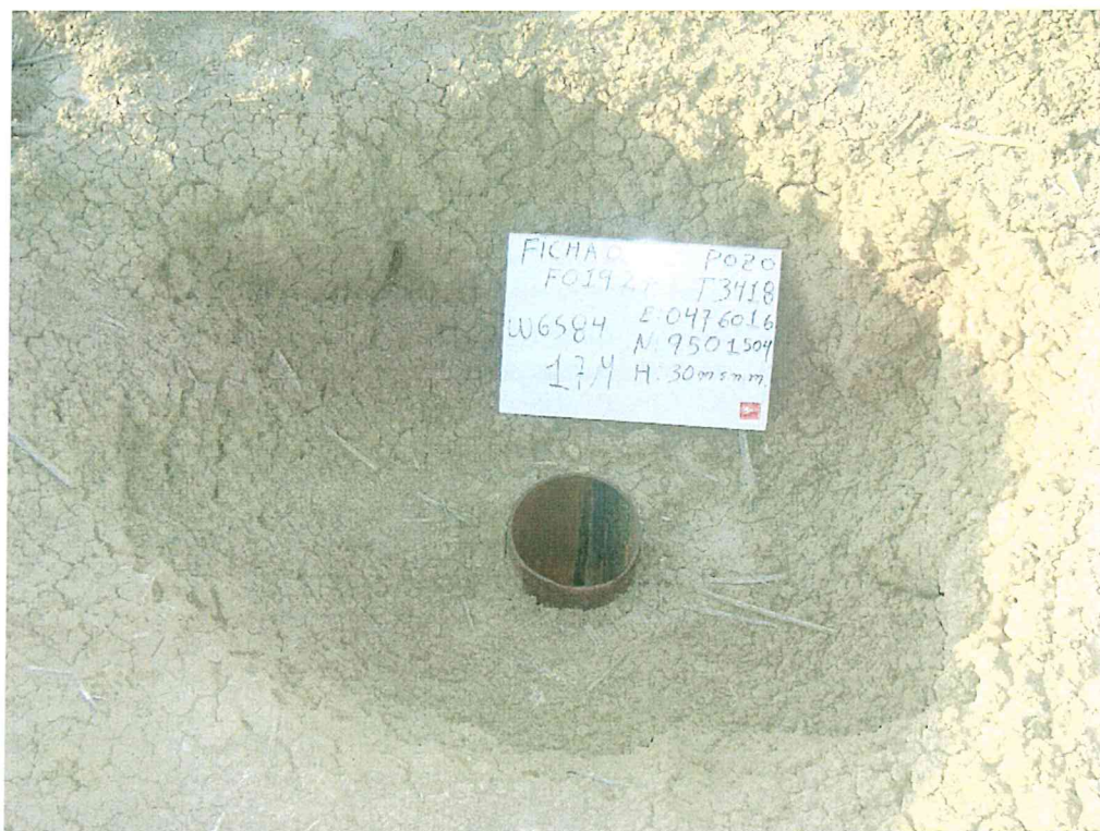
Fotografía N° 1. Vista pozo T3418 ubicado en un hoyo, se observa el casing expuesto al ambiente.
