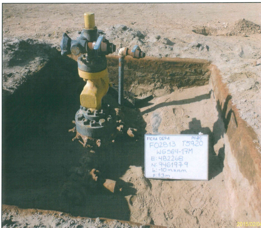
Fotografía N° 1. Cabezal de pozo inactivo con código PERUPETRO T5920 que sobresale desde el interior de una cantina de 0,5 m de profundidad.
