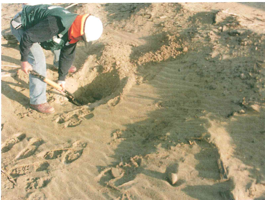
Fotografía N° 1. Pozo T1918 no ubicado superficialmente, en la zona se observa una depresión del terreno donde presumiblemente este ubicado el pozo.
