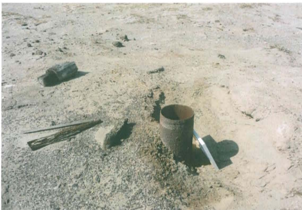
Fotografía N° 1. Vista de la ubicación del pozo se observa el casing abierto al ambiente sin cabezal y corroído.
