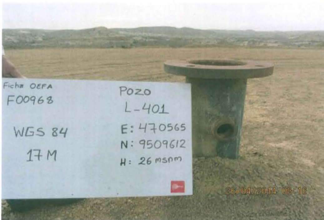
Fotografía N° 1. Se observa cabezal del pozo que se encuentra abierto al ambiente.
