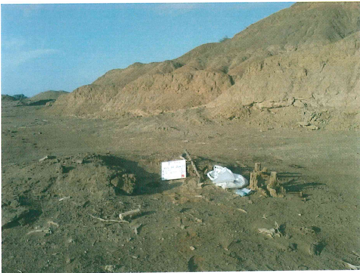
Fotografía N° 2. Vista de pozo, el cual no cuenta con terraplén ni acceso vehicular habilitado, se observa el casing sin cabezal ni válvulas por lo que se considera abierto.
