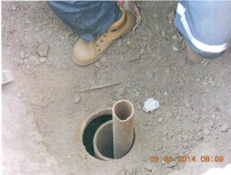
Fotografía N° 3. Se observa casing de superficie de 13 plg, casing intermedio de 7 plg y una tubería de 3 plg de diámetro respectivamente.
