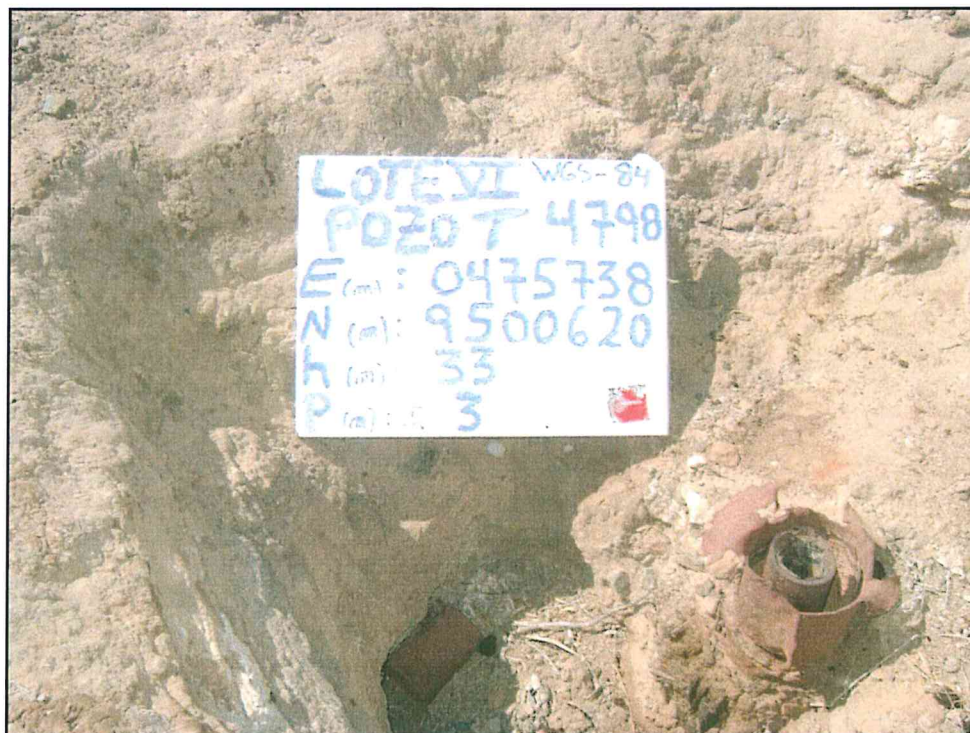
Fotografía N° 1. Se observa pozo mal abandonado con casing deteriorado, sin tapón y expuesto al aire libre.
