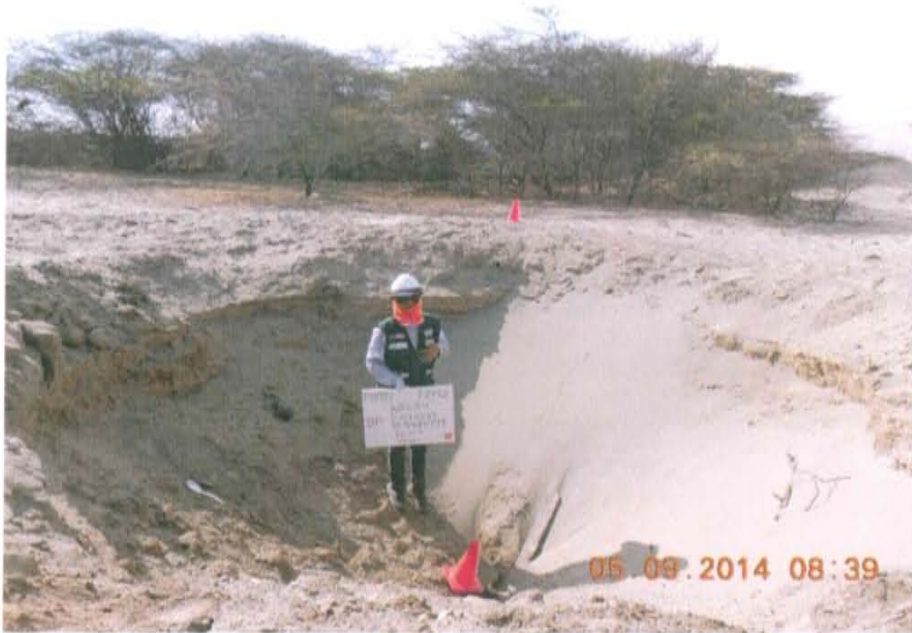
Fotografía N° 1. Ubicación del pozo inactivo en el interior de una excavación, con casing expuesto al ambiente.
