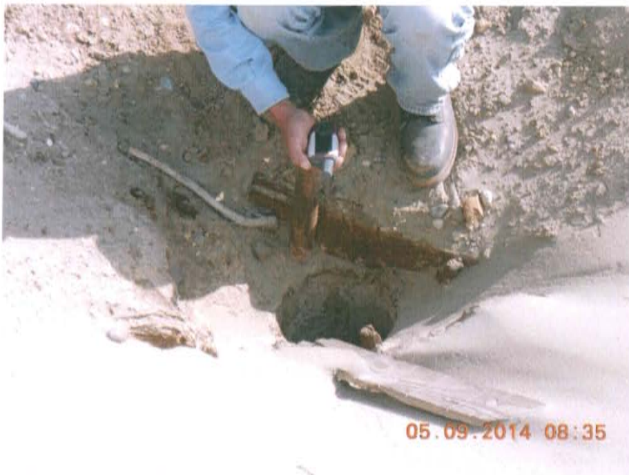
Fotografía N° 2. Se observa pozo inactivo que presenta una casing el cual se encuentra abierto, sin elemento de cierre tales como válvulas, llaves entre otros, que garanticen un cierre hermético del pozo.
