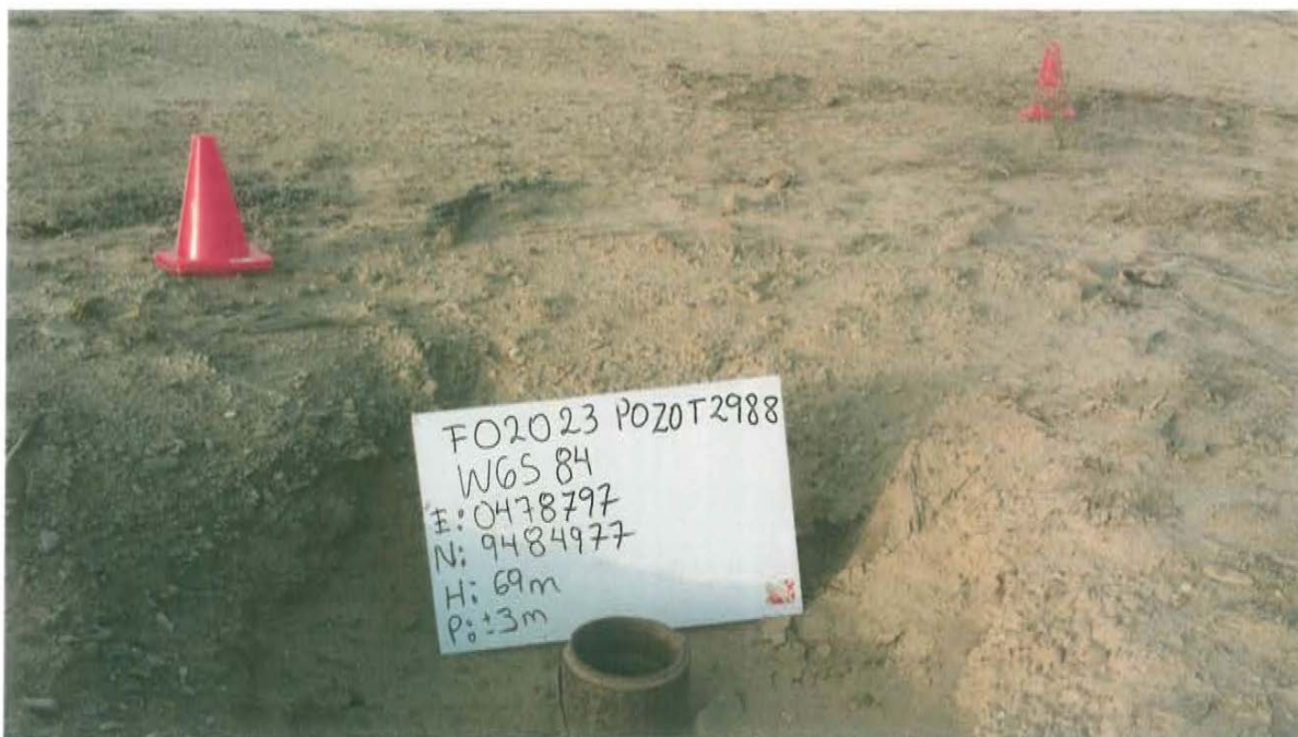
Fotografía N° 1. Pozo T2988, presenta casing corroído y abierto al ambiente a nivel de la superficie del suelo.
