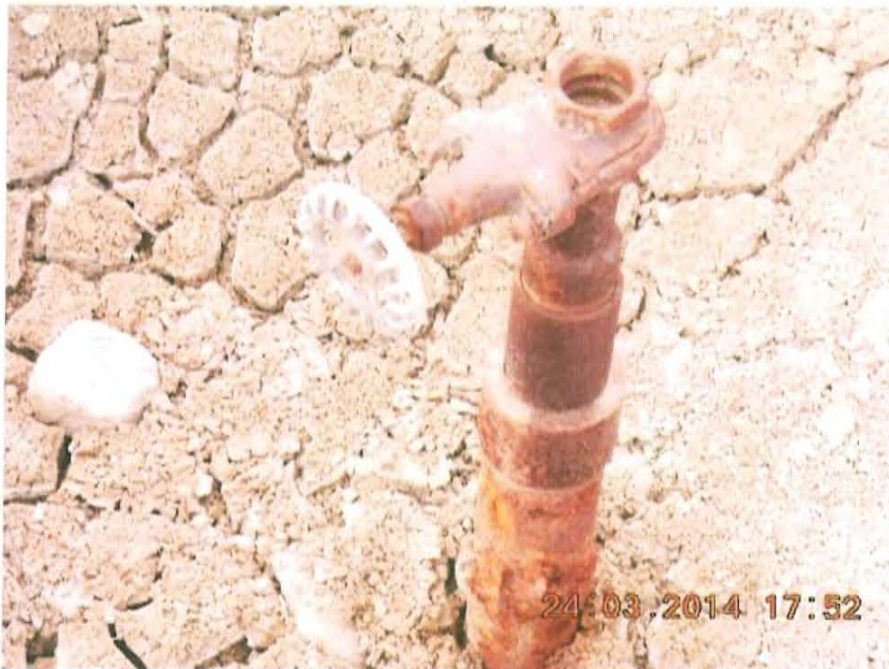
Fotografía N° 2. Tubería oxidada de 3 plg de diámetro que sobresale 1 m del suelo, el disco interno de la válvula de retención se encuentra corroído y no asegura el hermetismo del pozo.
