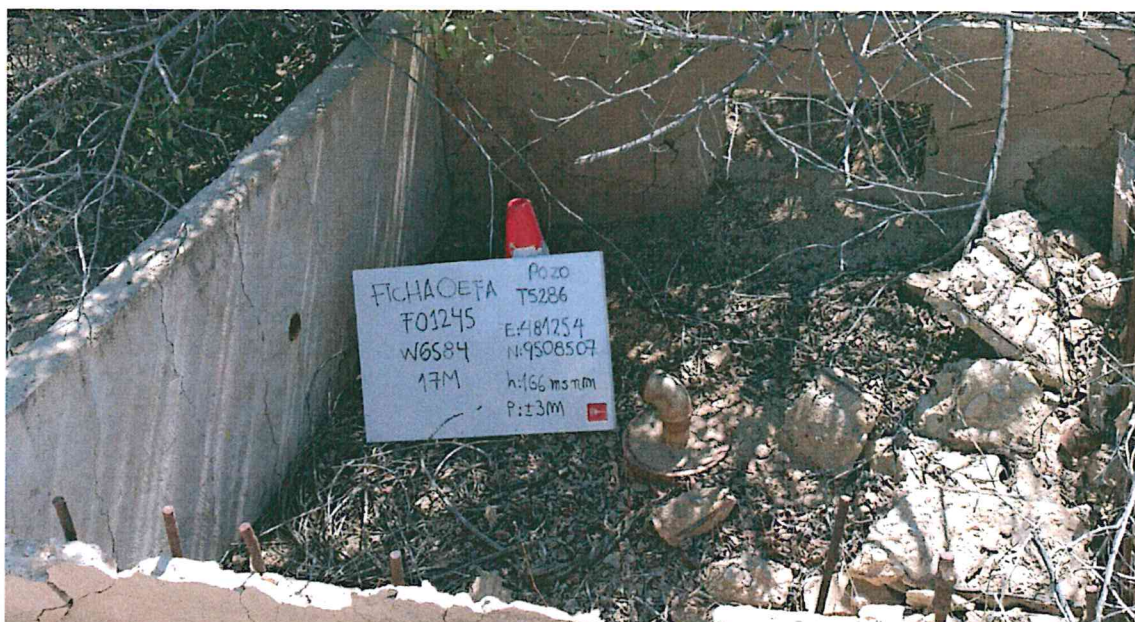
Fotografía N° 2. Vista del pozo petrolero inactivo, se observó casing el cual estaba acoplado con un codo de 3 pulgadas diámetro y un niple 2 pulgadas de diámetro.
