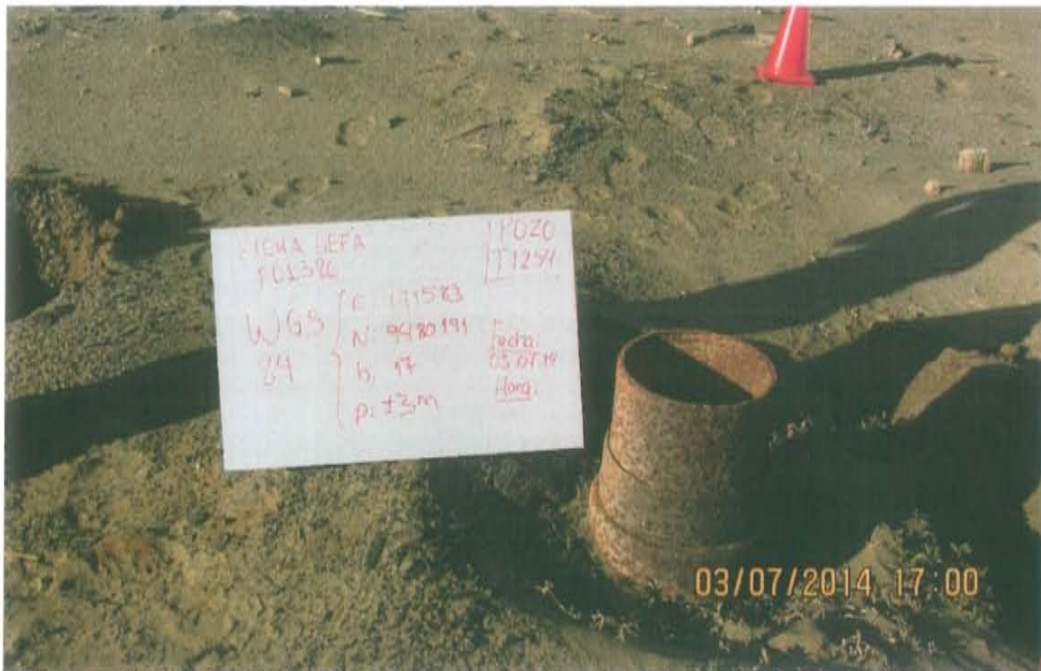
Fotografía N° 1. Se observa casing corroído que sobresale 0,4 m y se encuentra abierto al ambiente.
