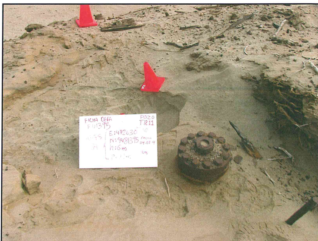
Fotografía N° 2. Pozo con código PERUPETRO T1211; con cabezal corroído que emerge a una altura de 0,2 m desde la superficie del suelo.
