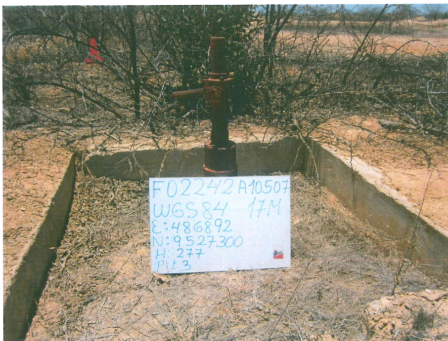
Fotografía N° 1. Pozo ubicado en el interior de una posible cantina de sección cuadrada, con visibles signos de corrosión con código PERUPETRO A10507.
