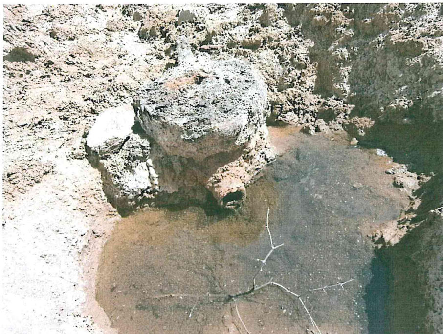
Fotografía N° 1. Vista del pozo con código L2013 donde se observa el casing unida a una brida en la parte superior y con signos visibles de corrosión.
