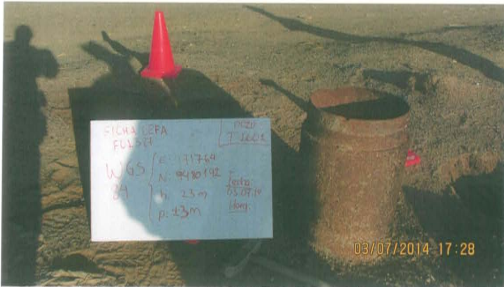
Fotografía N° 1. Se observa casing corroído y se encuentra abierto al ambiente.
