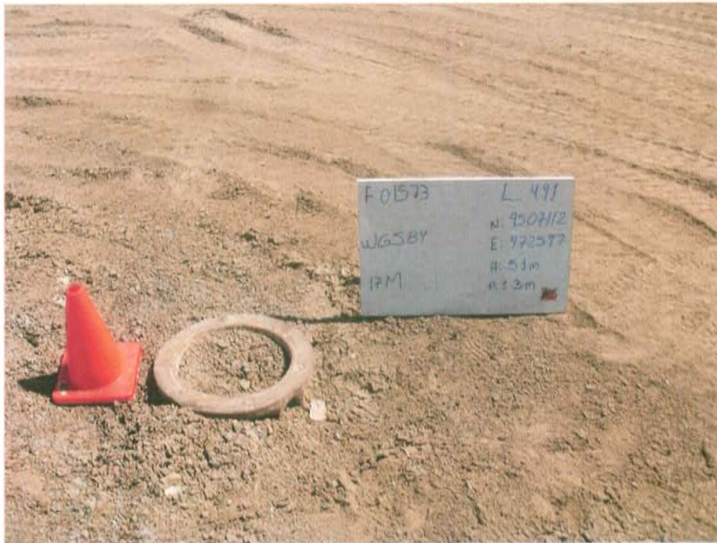
Fotografía N° 1. El pozo L_491 ubicado a nivel del terraplén se encuentra corroído cubierto con arena en su interior expuesto al ambiente sin hermeticidad.
