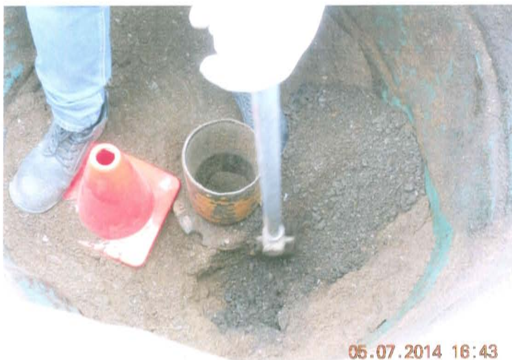
Fotografía N° 3. Se observó suelo con hidrocarburos en el interior de la conductora.
