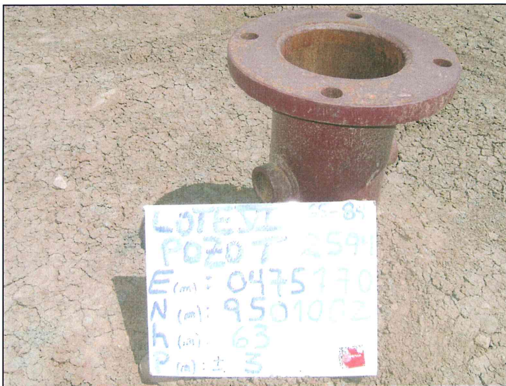
Fotografía N° 1. Se observa el Pozo T2594 que presenta casing abierto y expuesto al ambiente.
