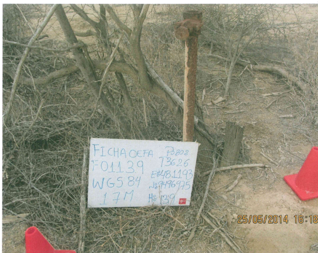
Fotografía N° 1. Se observa tubería de producción de aproximadamente 2 plg de diámetro con válvula que presenta signos de corrosión que posiblemente no asegure hermetismo del pozo.
