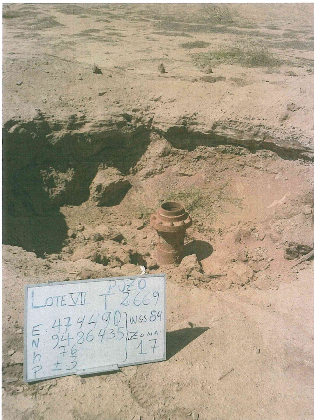
Fotografía N° 1. Vista del Pozo petrolero inactivo T2669, se observó casing cortado y corroído la cual presenta una brida, cuya estructura sobresale 0,9 m aproximadamente del nivel de superficie de suelo.
