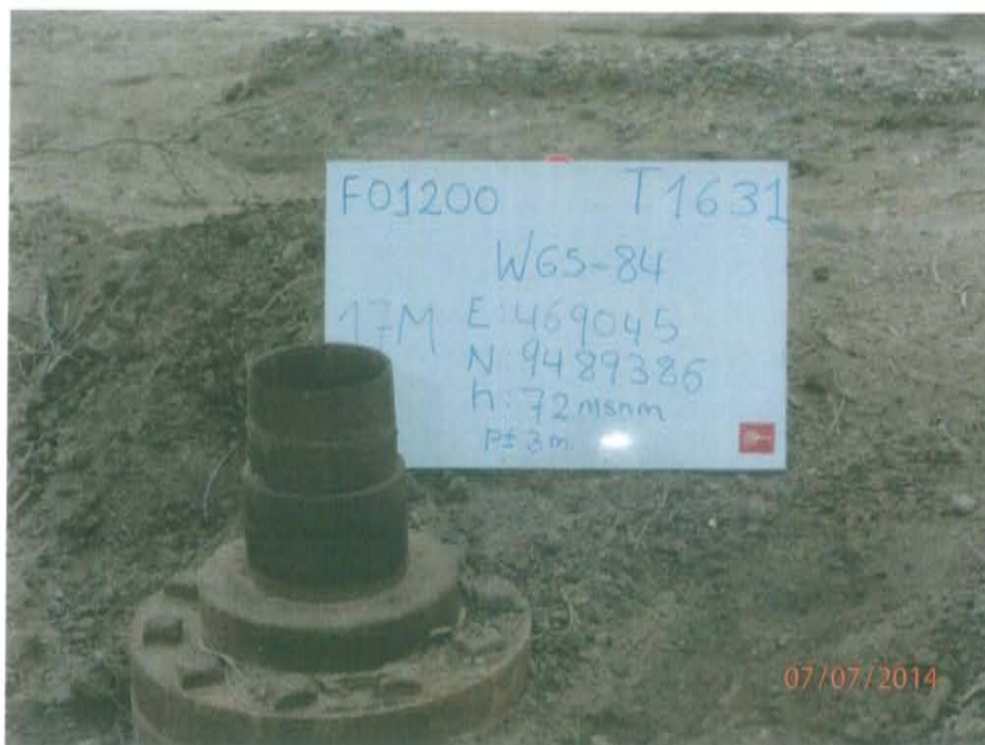
Fotografía N° 1. Pozo T1631, presenta casing con brida empernada, abierto al ambiente.
