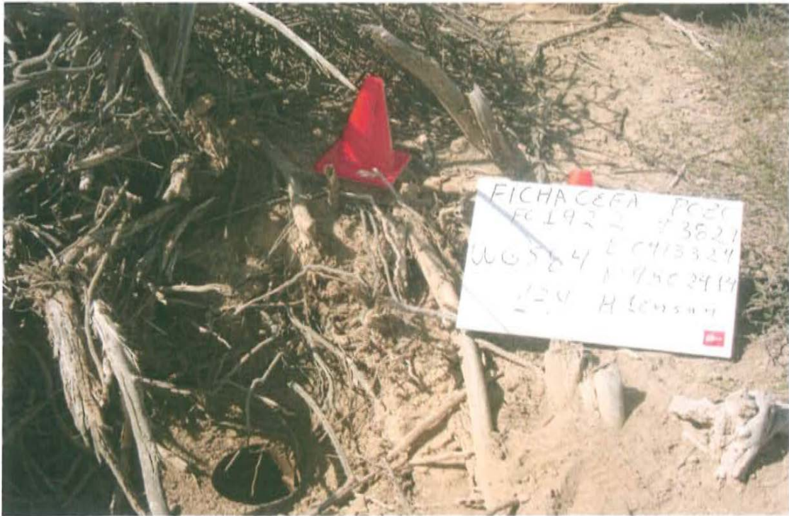
Fotografía N° 1. Pozo con código PERUPETRO T3827 y código Ficha OEFA F01922, se observa el casing y tubing corroídos a nivel de la superficie del suelo sin cabezal por lo que se encuentran expuestos al ambiente.
