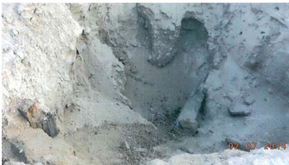
Fotografía N° 2. Se observa en las inmediaciones de la excavación, indicios de la existencia del pozo, tales como suelo con presencia de hidrocarburos y restos de madera en el área circundante.
