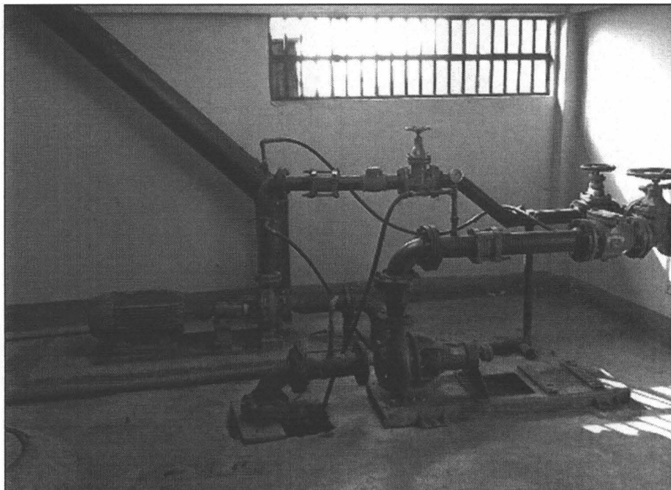
Foto 2: Bombas de la Estación CD-033.
