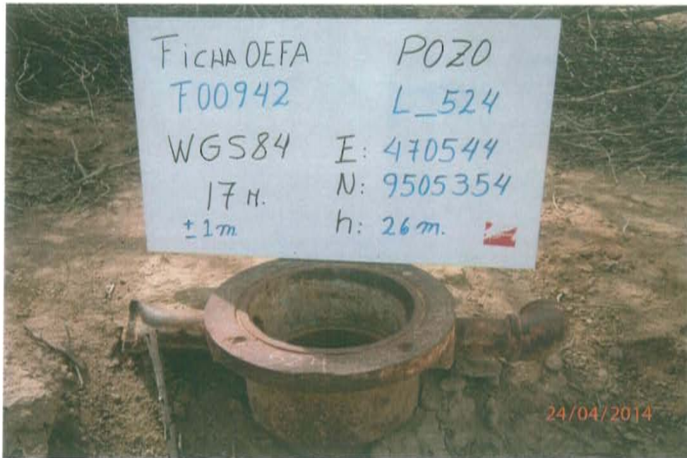
Fotografía N° 1. Vista de ubicación georeferencial donde se observa el pozo con el casing (Tubería de revestimiento) y brida abierto en estado de deterioro (corrosión)
