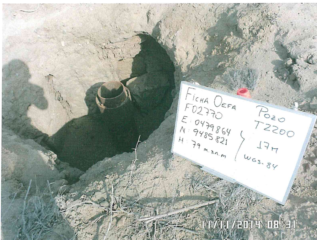
Fotografía N° 1. Vista pozo T2200 ubicado dentro de un hoyo, presenta el casing abierto al ambiente.
