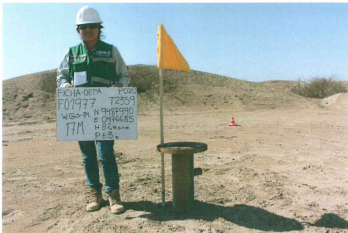
Fotografía N° 1. El Pozo T2359 presenta una brida unida al casing con una salida lateral, los cuales se encuentran abiertos y expuestos al ambiente.
