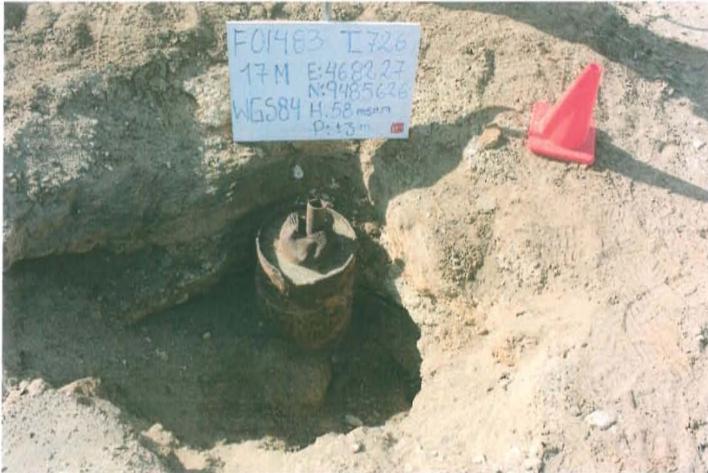
Fotografía N° 1. Pozo L_726, presenta casing de superficie y de producción con tubing, taponeados con tierra.
