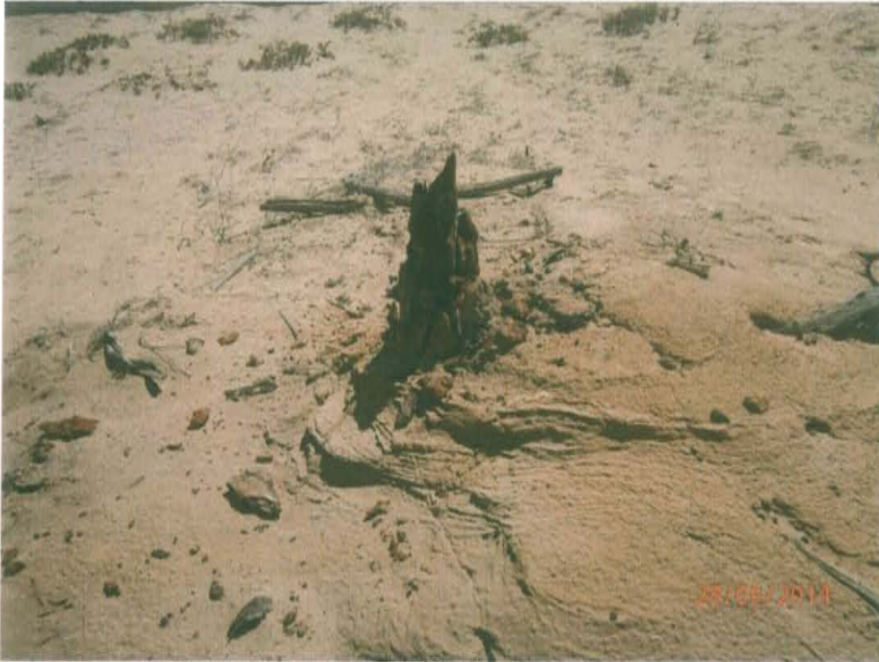
Fotografía N° 1. Vista de ubicación del pozo donde se observa el pozo con el casing y brida en estado de deterioro y abierto.
