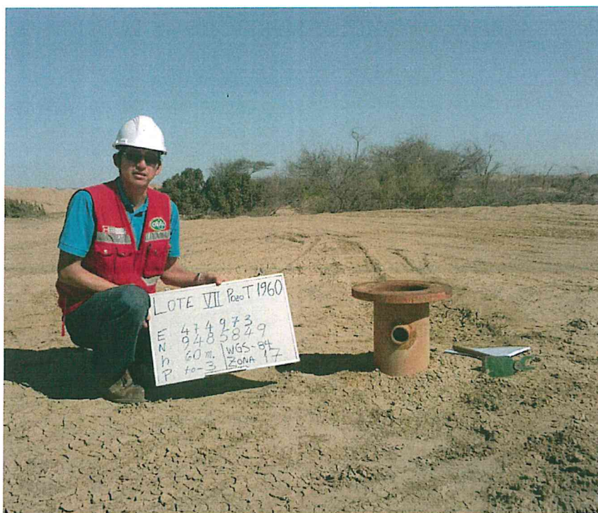
Fotografía N° 2. Se observa que la estructura del pozo que presenta casing cortado abierto carente de elementos de cierre que garanticen el cierre hermético del pozo.
