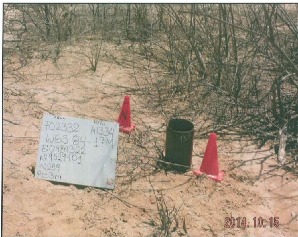
Fotografía N° 1. Pozo A1334 con casing corroído de 9,5 plg que emerge a una altura de 0,3 m desde la superficie del suelo.
