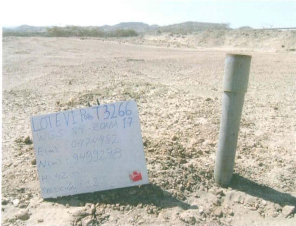
Fotografía N° 1. Se observa pozo con código PERUPETRO T3266 mal abandonado con casing sin tapón y expuesto al aire libre
