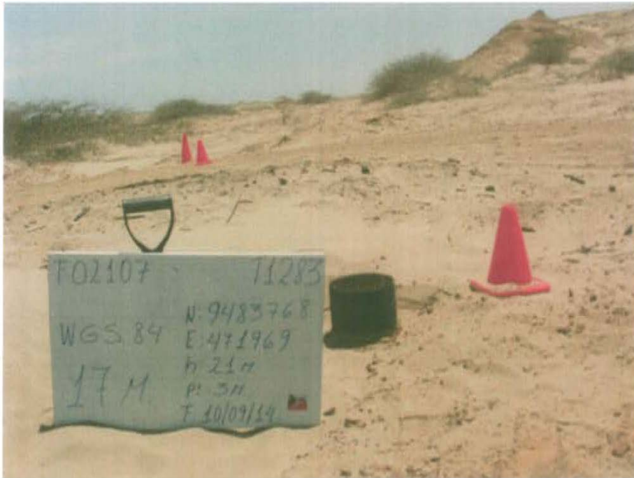
Fotografía N° 1. El pozo T1283 no presenta cabezal solo una tubería de revestimiento de 8 pulgadas expuesta al ambiente sin ningún elemento de cierre que garantice su hermetismo.
