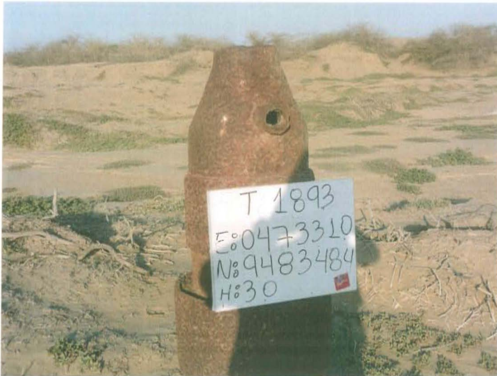
Fotografía N° 1. Pozo inactivo mal abandonado, de 6 pulgadas de diámetro y 1,7 m sobre el nivel del terreno, corroído, con casing sin accesorios que aseguren su hermetismo.
