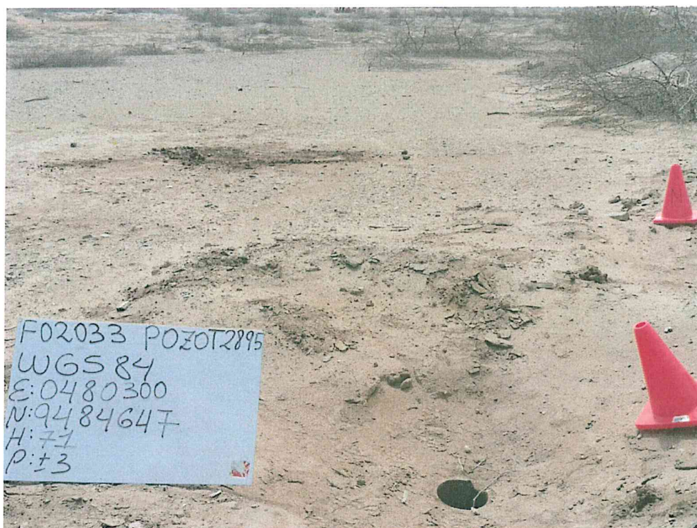
Fotografía N° 1. Pozo T2895, presenta casing en estado de corrosión a la misma altura que el nivel del suelo de un hoyo sin accesorios que aseguren su hermetismo por lo que se le consideró como un pozo abierto.
