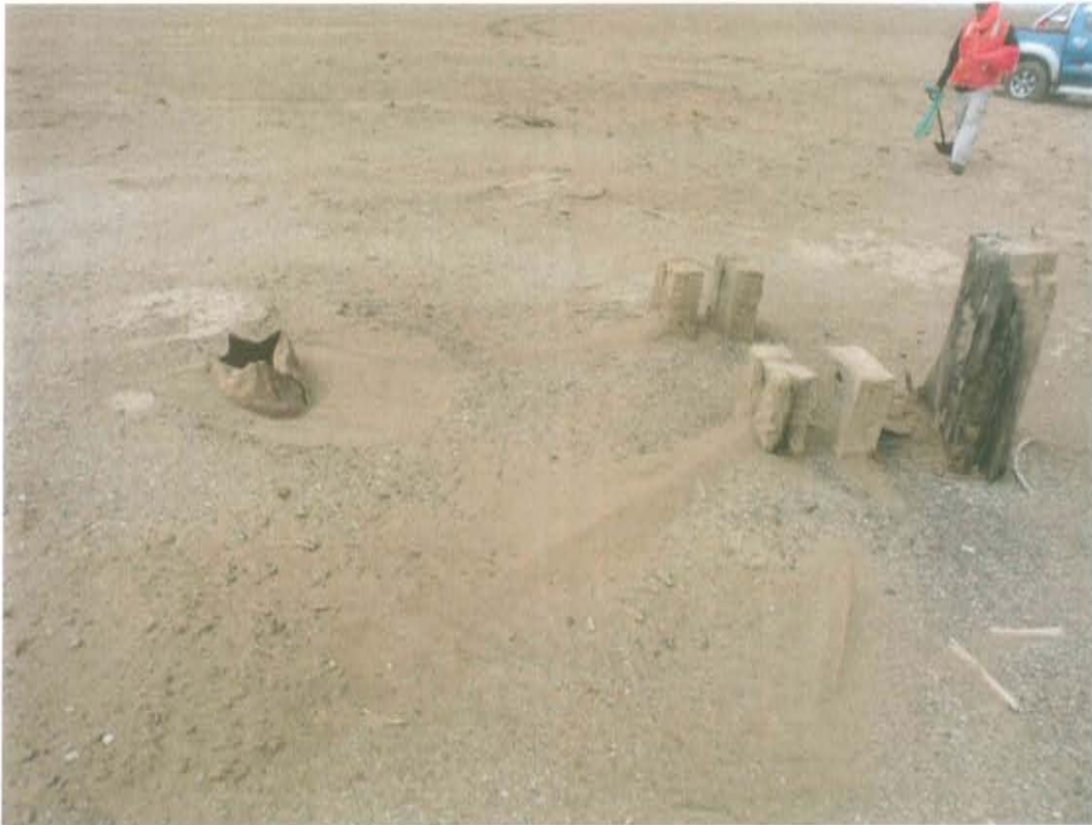
Fotografía N° 1. Pozo inactivo con código PERUPETRO T_667. Se observa conductora deformada sobresaliendo una altura de 0,2 m sobre el nivel del suelo.
