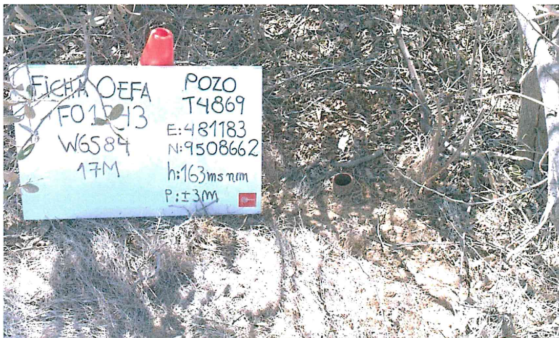
Fotografía N° 1. Vista del pozo petrolero inactivo, se observó casing cortado y corroído.
