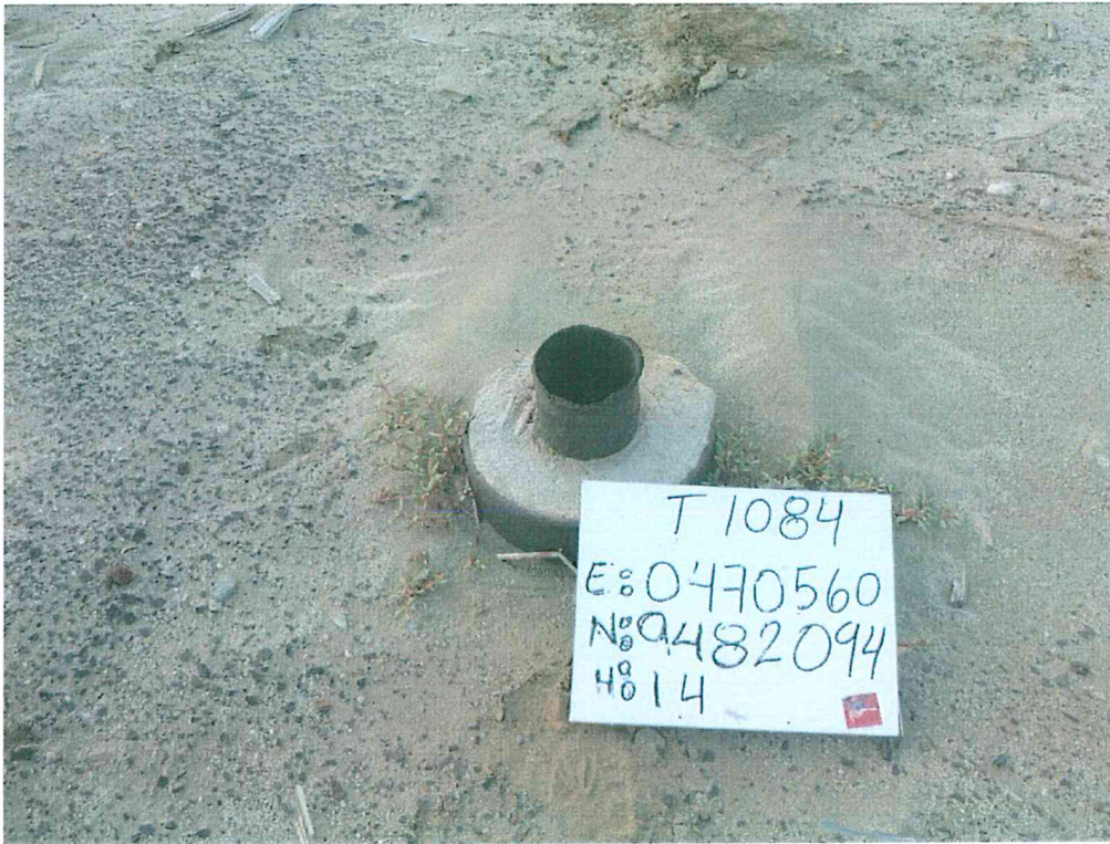
Fotografía N° 1. Pozo con código PETRUPETRO T1084 inactivo mal abandonado, sin cabezal, con casing cementado y tubo interior corroído.
