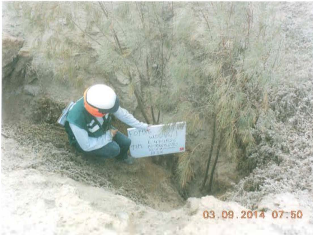
Fotografía N° 1. .Pozo inactivo con el casing corroído, se encuentra abierto y expuesto al ambiente.
