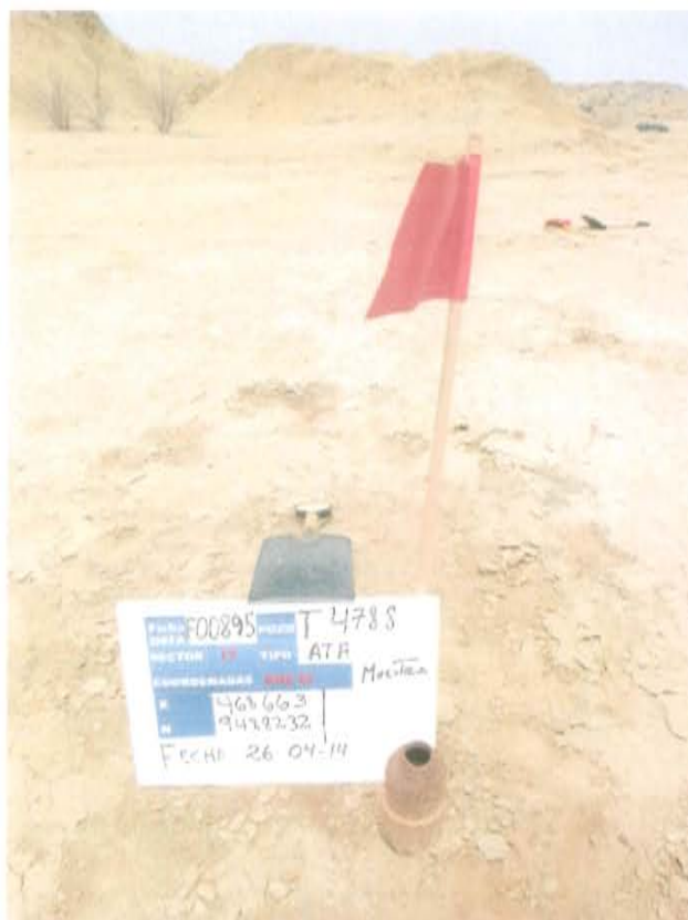
Fotografía N° 1. Pozo T4788, presenta casing con tubería de reducción corroído y abierto.
