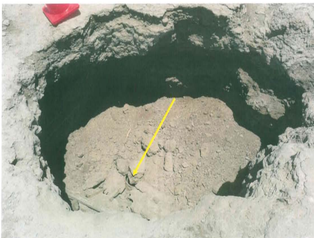
Fotografía N° 2. Detalle del Pozo T3124, presenta casing de 0,05 m de altura sobre el nivel del suelo del hoyo, sin accesorios que aseguren su hermetismo por lo que se consideró como un pozo abierto y expuesto al ambiente con avanzado estado de corrosión.
