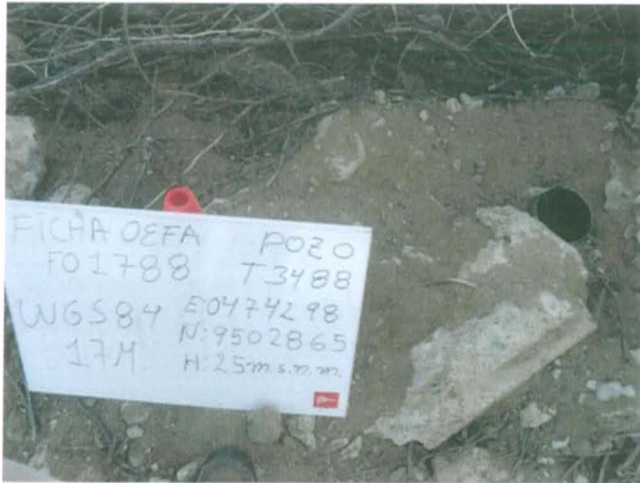
Fotografía N° 1. Se observa el casing abierto sin elementos de cierre en superficie (llaves, válvulas entre otros) que garantizan un cierre hermético del pozo.
