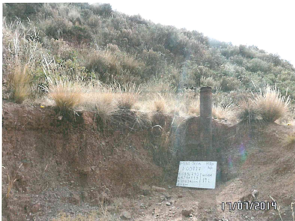
Fotografía N° 2. Vista de las del pozo encontrado y de los alrededores donde se puede observar que ha habido desprendimiento de suelo dejando el casing expuesto.
