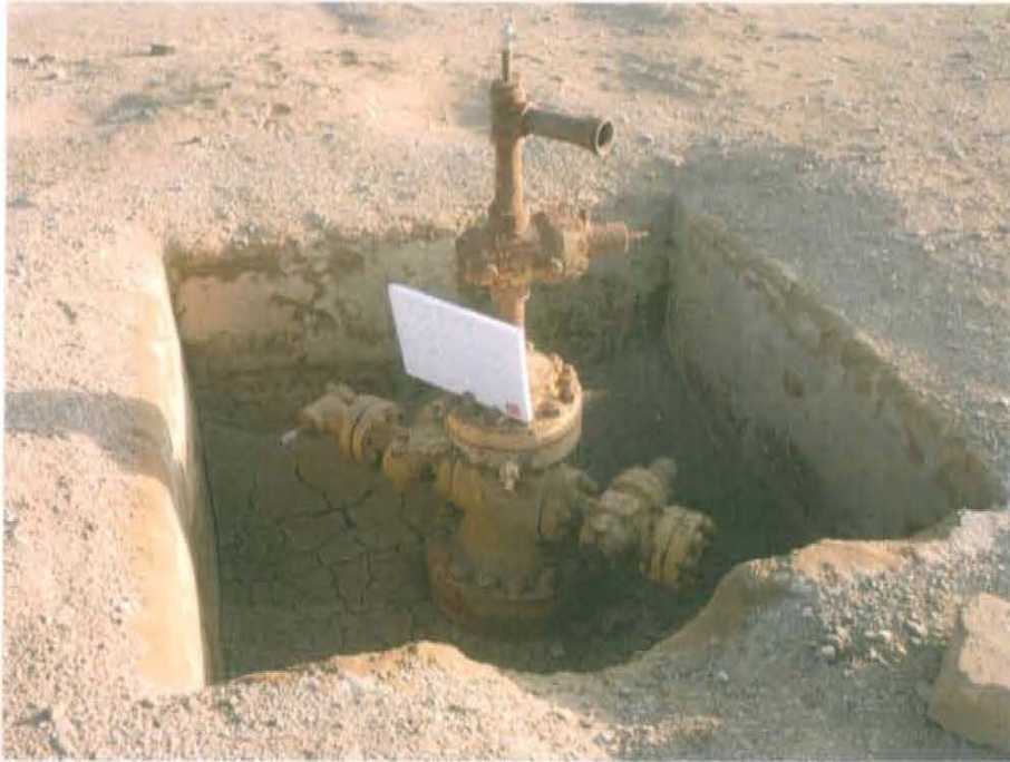
Fotografía N° 1. Pozo inactivo con cabezal, brida y válvula de cierre dentro de cantina deteriorada, no se evidencia afloramiento de fluidos ni suelo impregnado con hidrocarburo.
