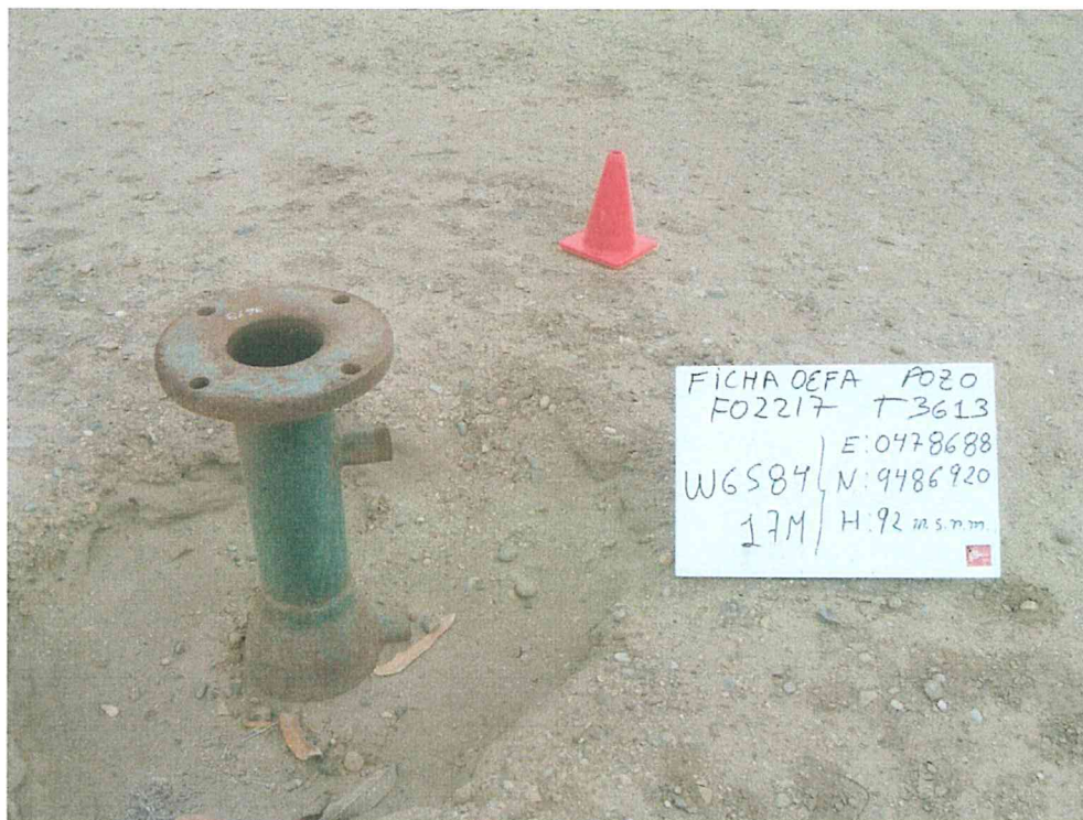
Fotografía N° 1. Pozo T3613 con cabezal sin válvulas que aseguren su hermetismo, por lo que se encuentra abierto y expuesto al ambiente.
