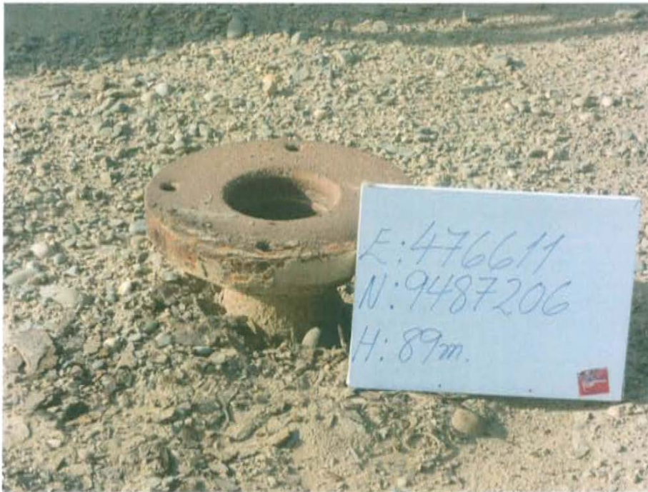
Fotografía N° 1. Pozo inactivo con código PERUPETRO T2294, no se observa superficialmente cabezal del pozo en su lugar se tiene el casing unida a brida de 6 pulgadas de diámetro.
